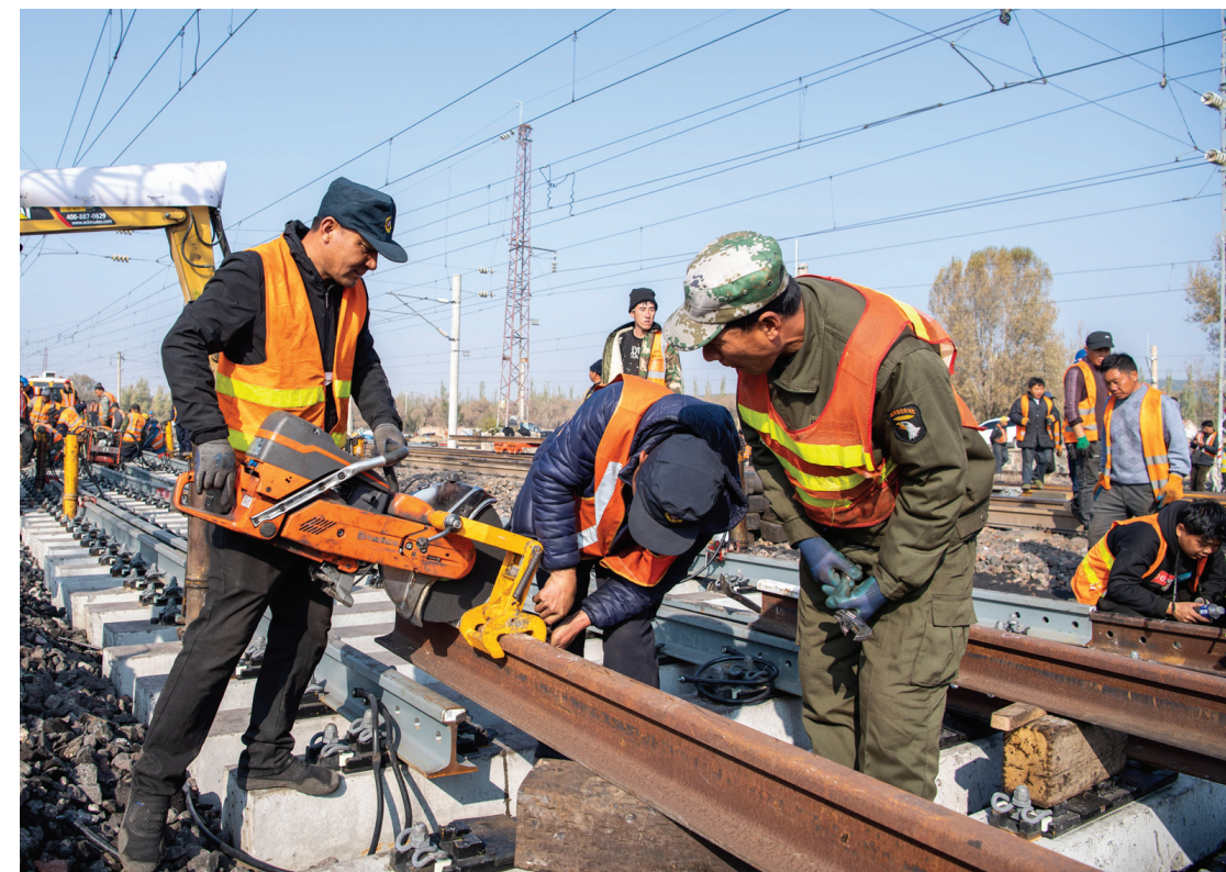
↑10月26日,记者从中国铁路太原局集团有限公司了解到,我国运煤大动脉大秦铁路秋季集中修接近尾声,即将恢复高位运行。 大秦铁路西起山西大同,东至河北秦皇岛,是我国第一条双线电气化重载运煤专线,用户群涵盖我国六大电网、五大发电公司等6000多家企业。 新华社记者 杨晨光 摄
